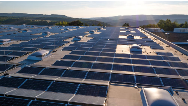
Fachgerecht ausgeführte PV-Anlage in Ost-West-Ausrichtung auf Flachdach, (Foto: Wi SOLAR GmbH)
